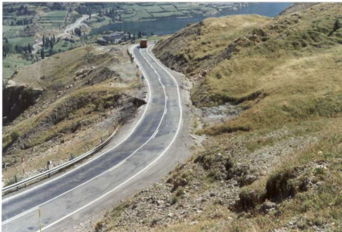
Fotografía n.º 2. Punto n.º 4. Sumidero al pie de la pendiente que produce las socavaciones de la carretera. Obsérvese la perfecta relación de ambos casos: encharcamiento y filtraciones con socavamiento.
