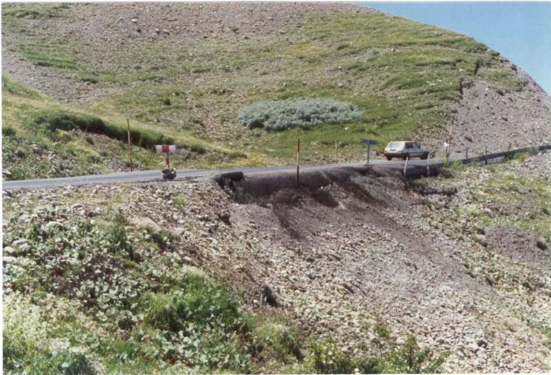
Fotografía n.º 3. Punto n.º 4. Cuneta exterior de la carretera fuertemente rellena. Tomar como referencia la situación de la valla metálica.
