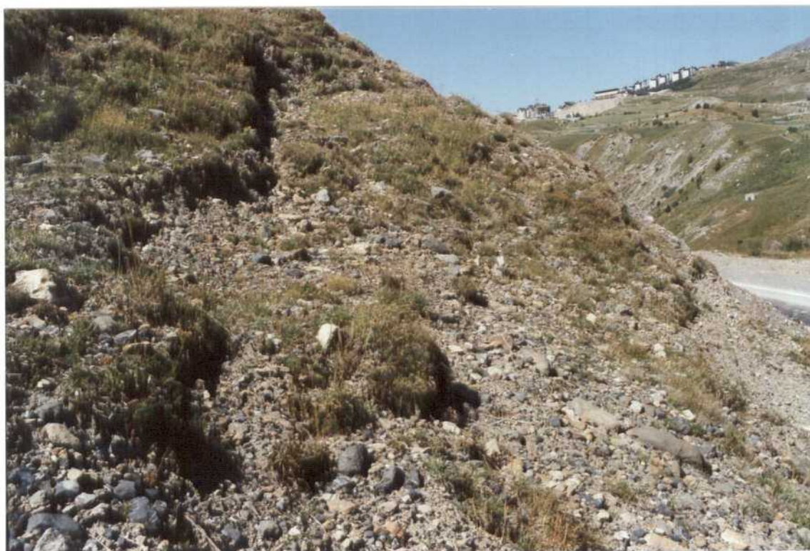
Fotografía n.º 5. Deslizamiento progresivo pendiente arriba de la ladera superior de la carretera en el punto n.º 4. Obsérvese las dos grietas consecutivas.
